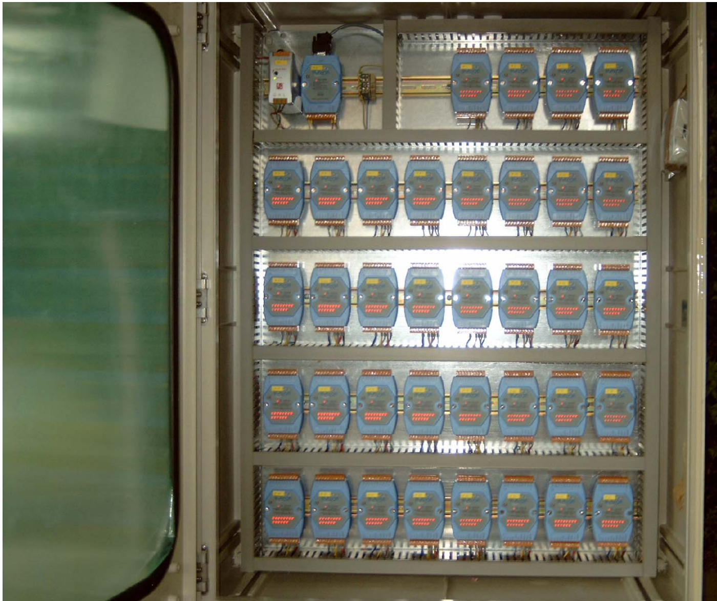
Beispiel 1: 490 Eingänge, Rittal-Schaltschrank 800x1000x300 mm BxHxT, Sichtfenster in der Tür
